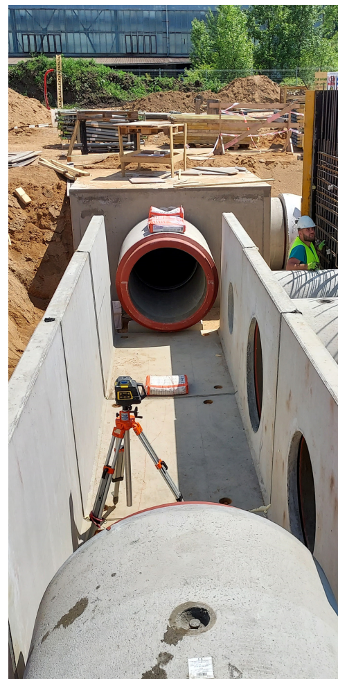
02. Brno - Průchozí dvoupatrový kolektor. Kombinace rámových propustků, energokanálů, trub, nádrží.
